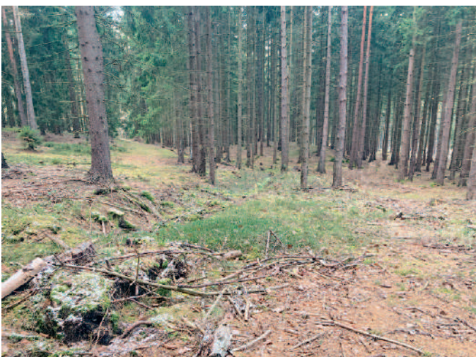
Příkop, propad vstupní části štoly směrem k plošině výsypky dolu pod Podlužskou horou, pohled z horní části propadu k cestě na Felbabku.
